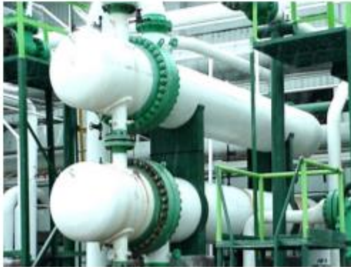
Intercambiadores de Calor
